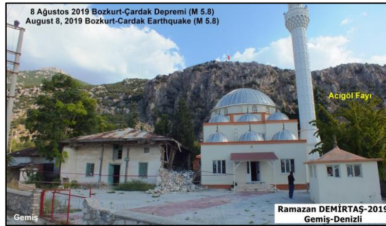
Şekil 14. 08 Ağustos 2019 Çardak - Bozkurt depreminde Cami hasarı (Demirtaş, 2023)
